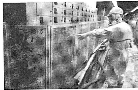
1号機のタービン建屋内(東京電力提供)
